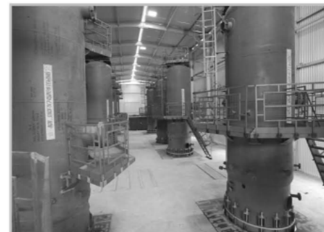
Здание входных ниток и сепарации газа Бованенковского НГКМ
